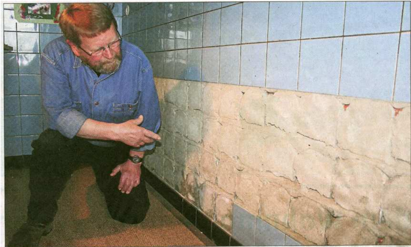
Manfred Rövekamp zeigt in seiner Küche auf die Wand, an der die Kacheln abgefallen sind. ■ Fotos: bor
