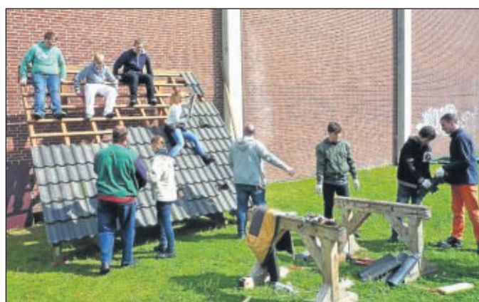
Dachaufbau am Zukunftstag: Die Konstruktion für die Pfannen hatte BBS-Lehrer Holger Adomat angeliefert – als Spende.
