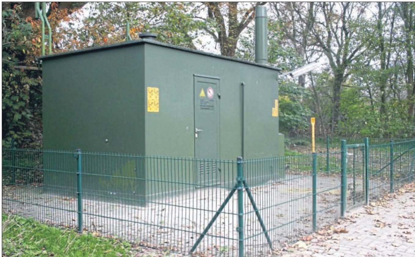
Unentbehrlich für das Erdgasnetz sind die Gasdruckregelstationen. Diese hier steht an der Schulstraße, Ecke „Am Langen Moor“.
