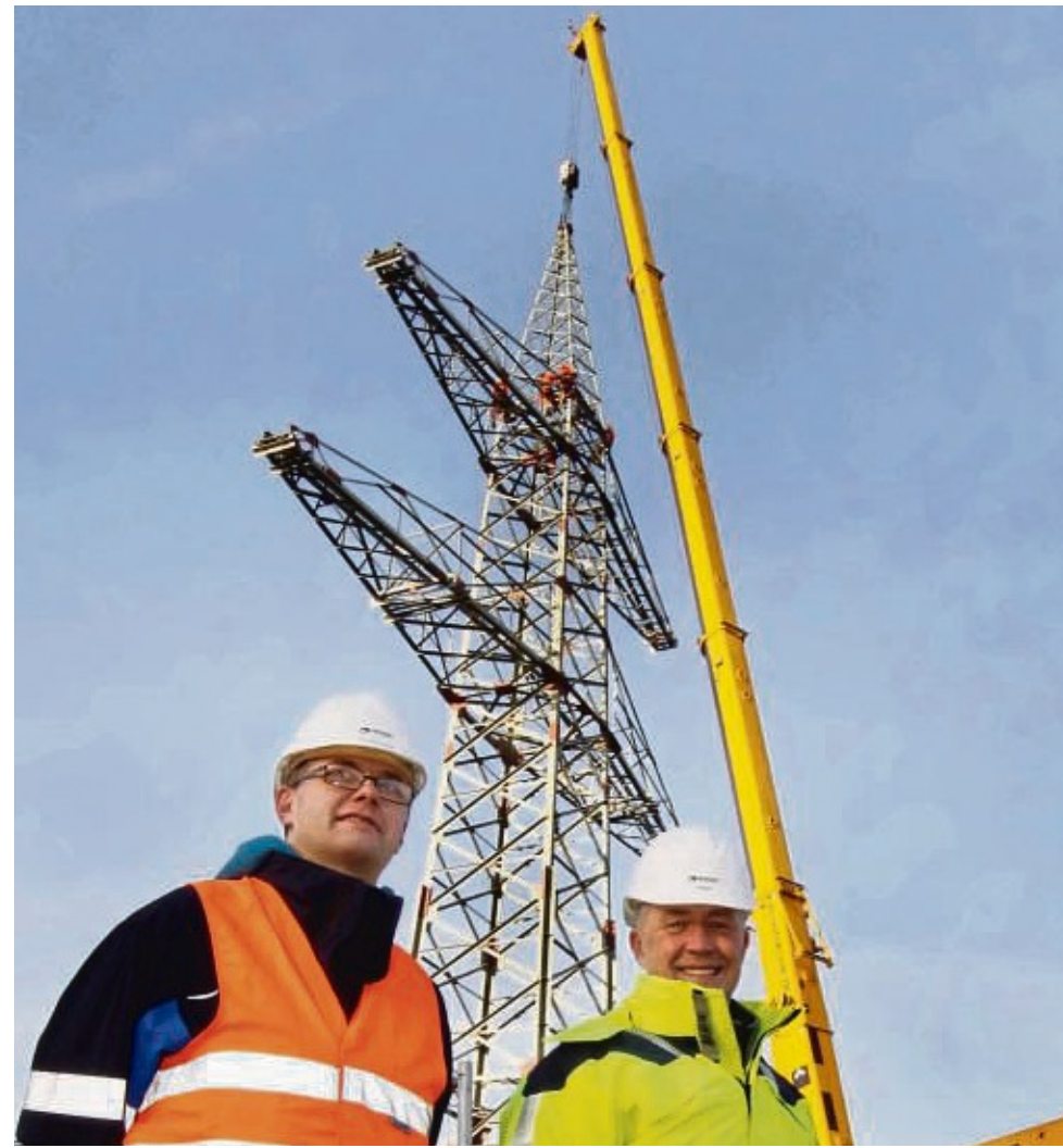
Über den Verlauf des Mastenbaus informierten Andreas Jaeger (r.) und Lars Holze-Lentas, während am Mast 28 in schwindelerregender Höhe gearbeitet wurde. FOTO: BOH
