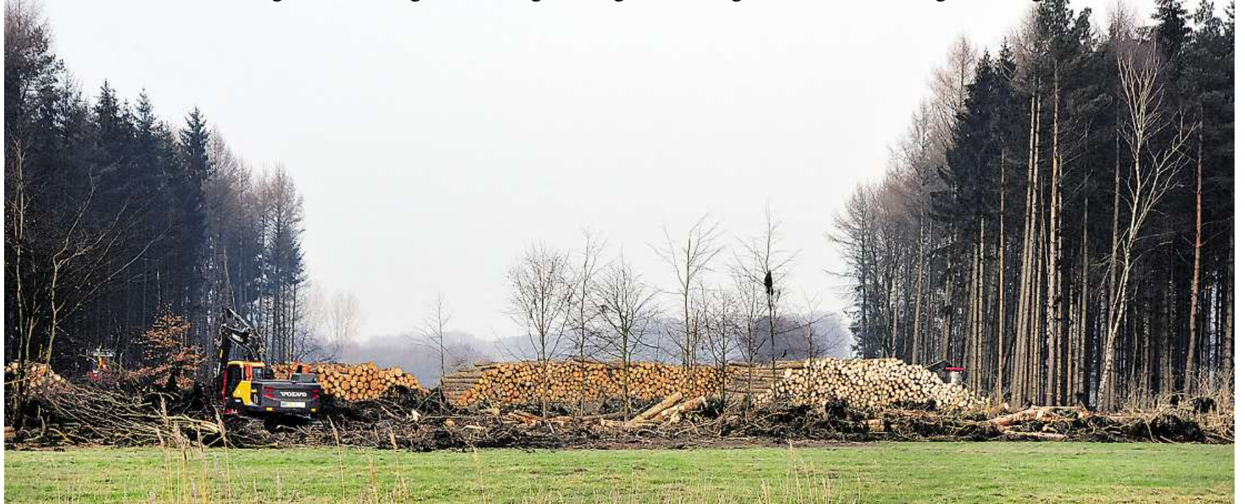
Eine Schneise für die Trasse: Aktuell finden Rodungsarbeiten in der Gemeinde Winkelsett statt, das Bild entstand in der Nähe des Windparks Spradau. Im Bereich des Trassenverlaufs wird ein etwa 60 Meter breiter Streifen ausgeholzt. Später wird hier eine Gebüsch-Vegetation angelegt. BILD: KARSTEN KOLLOGE
