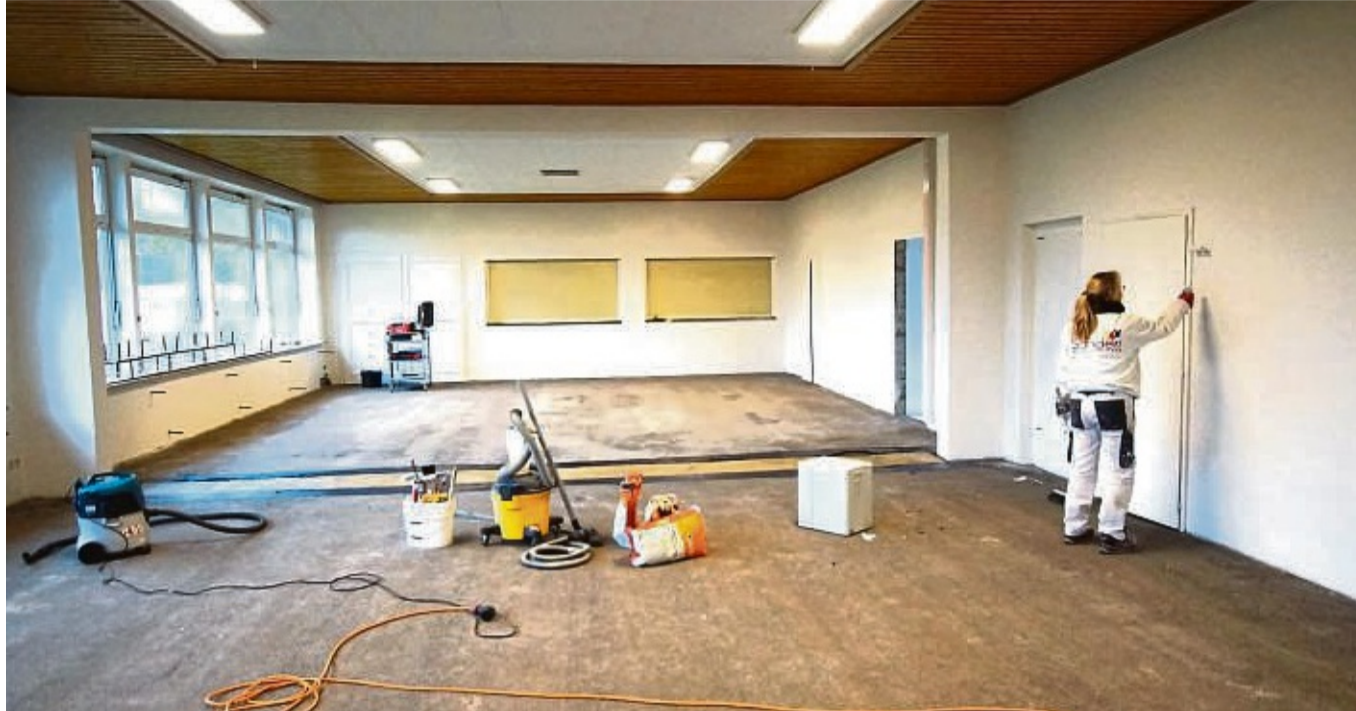
Ein Blick ins Colnrader Dorfgemeinschaftshaus: Hier sind die Wände gerade frisch gestrichen worden.
