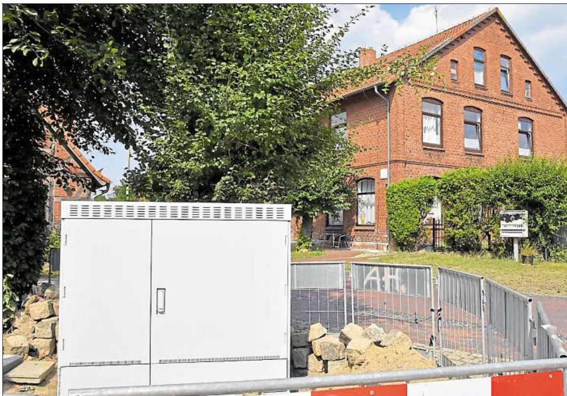
Der Anlass des Ärgers: dieser graue Verteilerkasten, der vor der denkmalgeschützten Fassade des Hauses Dorfstraße 12 in Colnrade aufgestellt worden ist.
