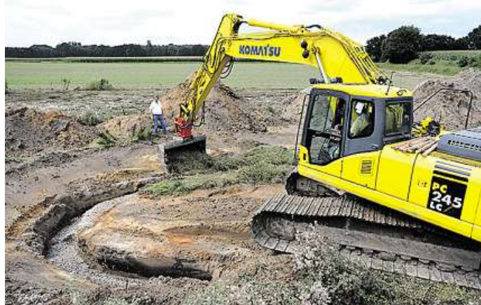
Vor einem Jahr: Das neue Bach-Bett entsteht. Ein Ziel war, die Fließgeschwindigkeit zu erhöhen. ARCHIVBILD: KARSTEN KOLLOGE
